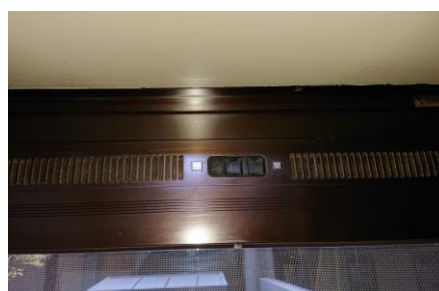
窓（サッシ）の吸気口
